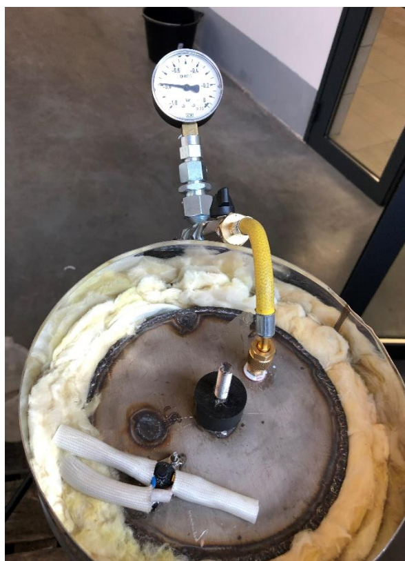
Fot. 5. Ogólny widok wymiennika kotła sonicznego centralnego ogrzewania typu KS
